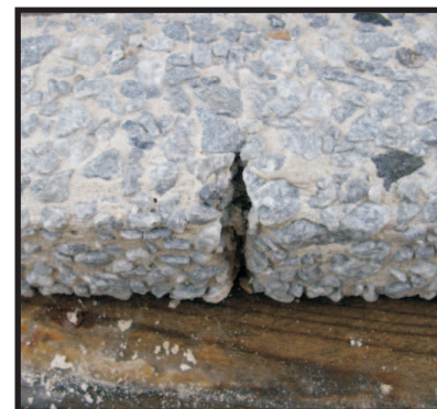
Sollbruchstelle in der Simsplatte.
