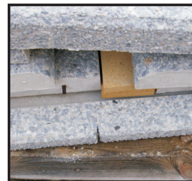
Sollbruchstelle in der Simsplatte.
